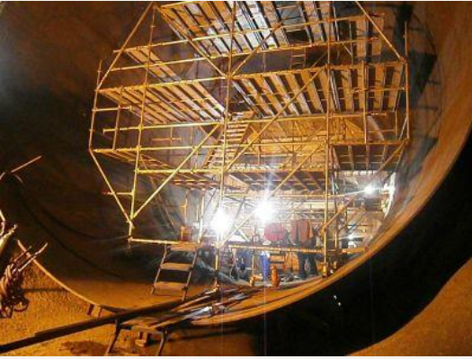
Hidroelektrik Santrallerinde Kullanılan Cebri Borular
